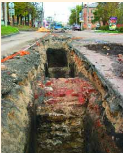
Строительная траншея на ул. Фрунзе, в которой хорошо видны фрагменты фундамента Покровского храма. Фото 2003 г.
